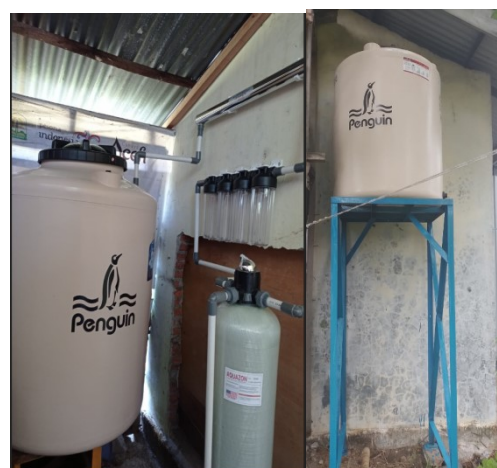
Gambar 1. Unit filtrasi air
